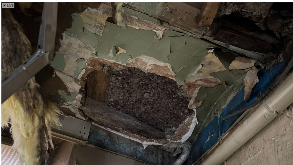
Photo plafond endommagé
