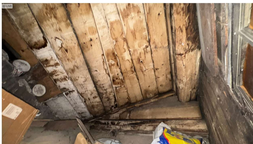
Aperçu traces d'infiltration au niveau des voliges
