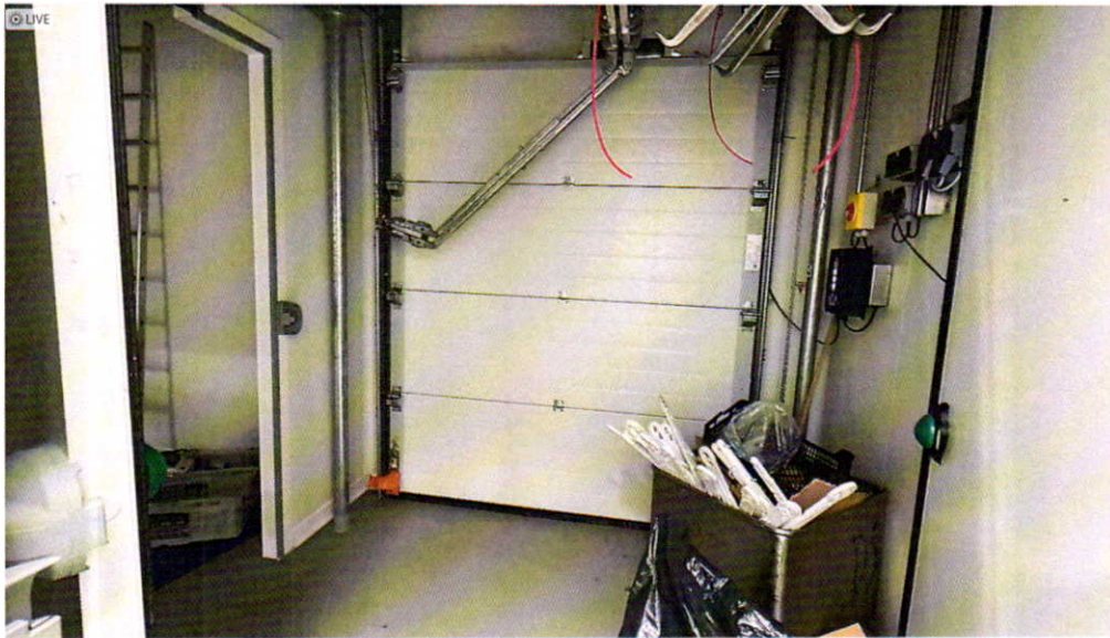
Accès quai avec porte sectionnelle (ouverture électrique)
