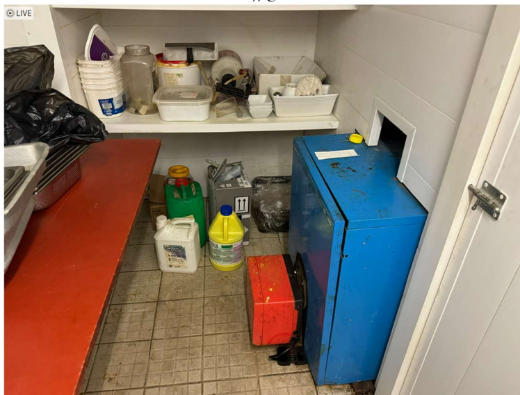
Aperçu chaudière de marque Buderus (Année 88)
